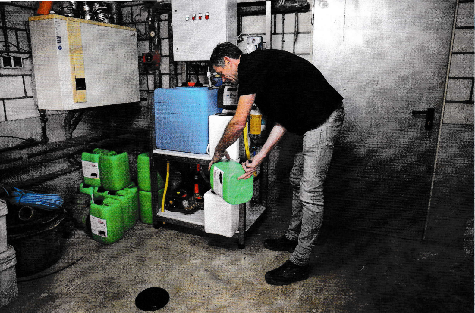
De installatie-unit staat in de centrale gang. Een keer per week vult Peter Verhees de voorraadbus van het spraymiddel met de bacteriën aan.
